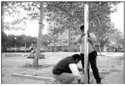
reanudación. Dos operarios vuelven a levantar las guías para colocar la valla de nuevo.
